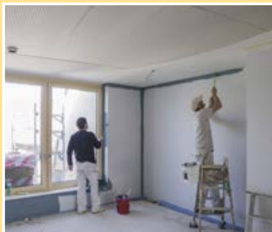
3. März 2015 Um einen geordneten Bauablauf zu gewähren, müssen sich die einzelnen Gewerke abstimmen.
