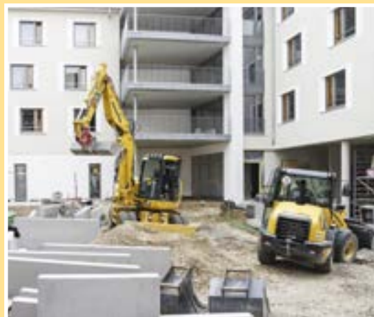
23. März 2015 Die Außenanlagen umfassen die Gestaltung des gesamten Geländes um das Marienhaus. Hier wird im Bereich des Innenhofes gearbeitet.
